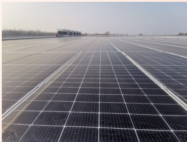
密雲光伏發電項目
